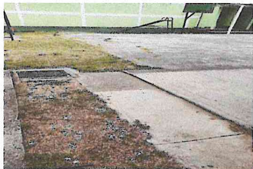
Foto1: Reparación de plancha de concreto de patio, la maleza rompió la plancha y se esta expandiendo
